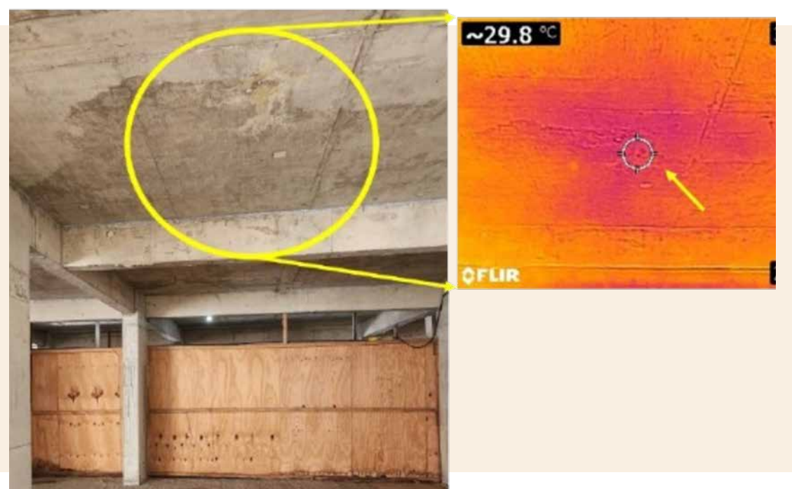
Figura 2 – Imagem termográfica com indicativo de umidade (tom rosado) em laje de cobertura da Garagem 2
