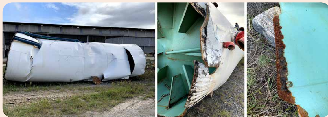
Imagem 3: Estrutura colapsada / junta perimetral com corrosão severa.
