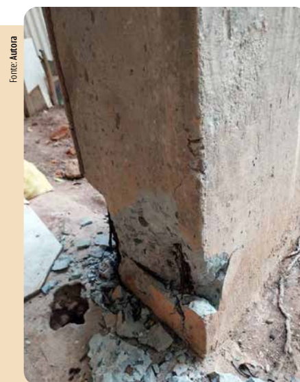
Figura 2 – Armadura oxidada no pilar
