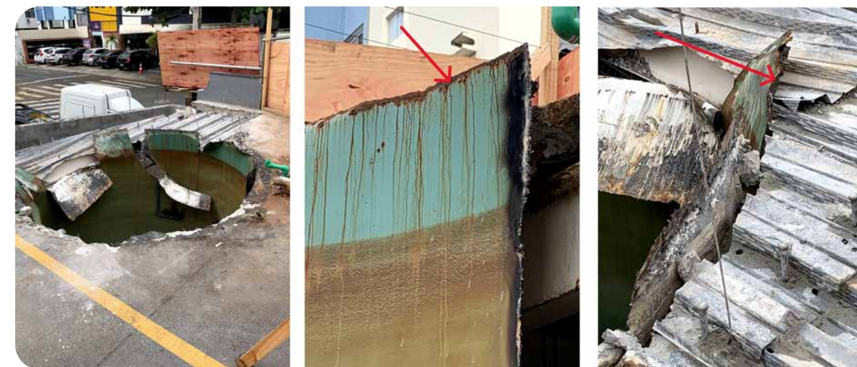
Imagem 2: Corrosão severa na junta soldada entre chapas do costado coincidindo com a zona de interface com a laje.
